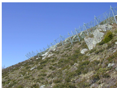
fig 1 - Vista generale di un intervento con opere attive continue e dettaglio di reti da neve
